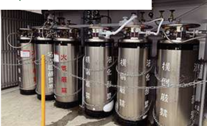
シリンダー容器・LGC供給設備 (カードル製作・集合装置)
