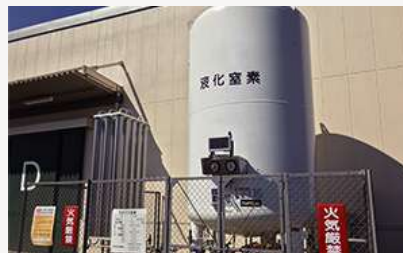
タンクローリー供給による液化ガス設備 (CE供給設備)
